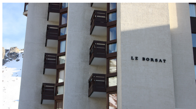
Constata entre menuiserie et couleur de façade, CAUE, 2015
