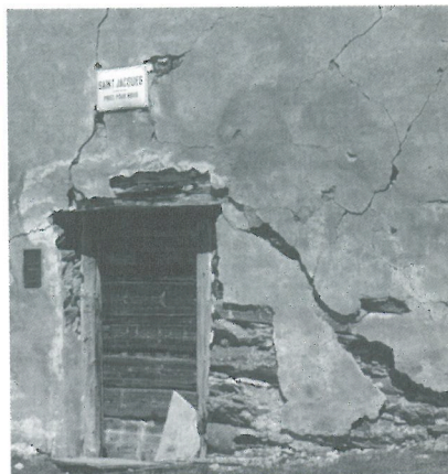
P oussée mal équilibrée d'un élément de charpente et infiltration dans la toiture.
